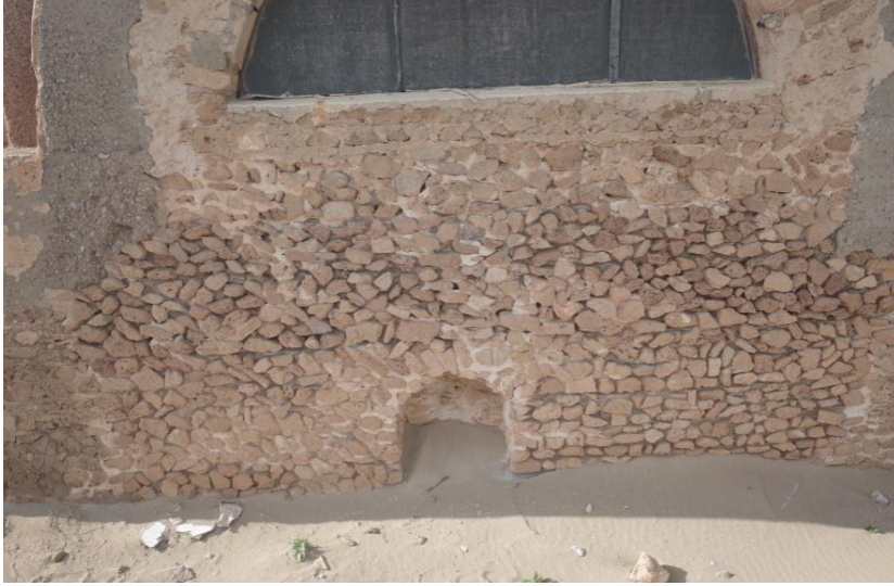
شكل رقم (15) تأثير الأمطار الحمضية في الجهة الشمالية في مبني حمامات الصيد من تصوير الباحث
