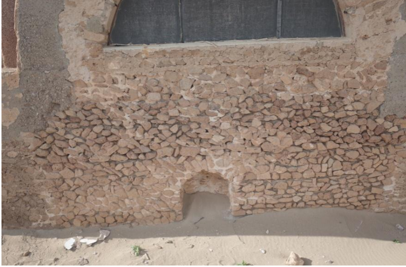
شكل رقم(15) تأثير الأمطار الحمضية في الجهة الشمالية في مبني حمامات الصيد من تصوير الباحث
