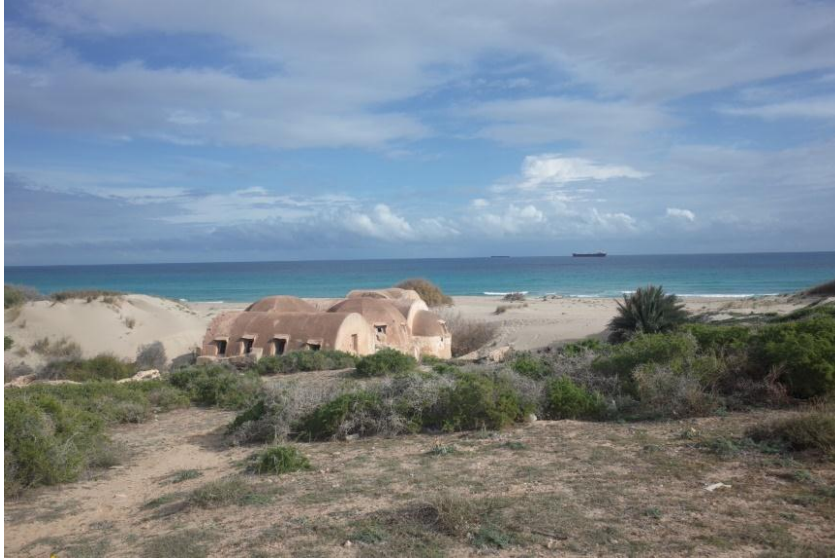
شكل رقم(16) توضح زحف الكثبان الرملية علي مبني حمامات الصيد من تصوير الباحث
